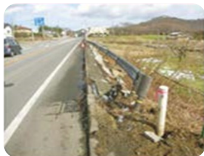
ガードレール・ 標識等の損傷
