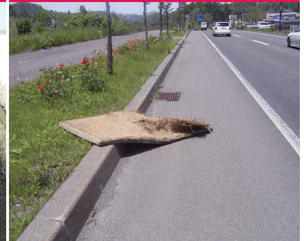
路面の落下物
