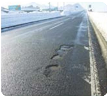
路面の穴ぼこ・ 段差
